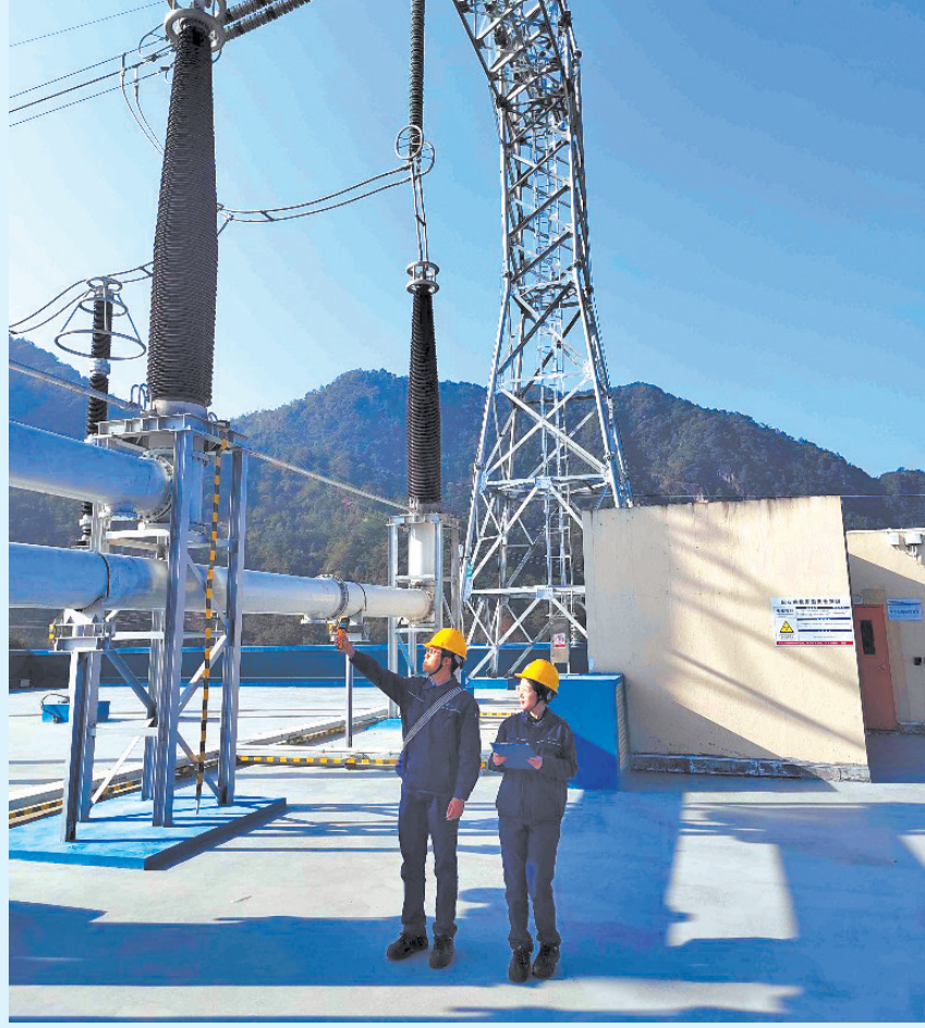
连日来,华电周宁抽蓄公司全面开展国庆节前安全大检查,确保国庆假期电力安全稳定供应。图为9月29日该公司运维人员正在进行设备巡检。林勃摄
