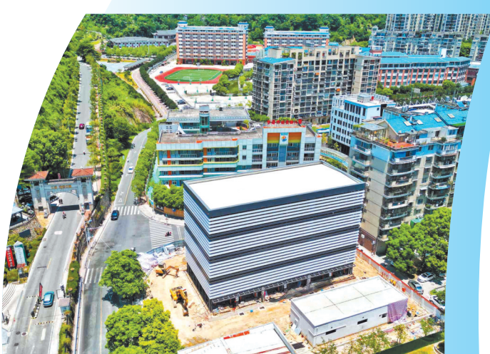
市青少年宫立体车库已进入项目收尾阶段,将于10月1日投入使用 本报记者 张文奎 摄
