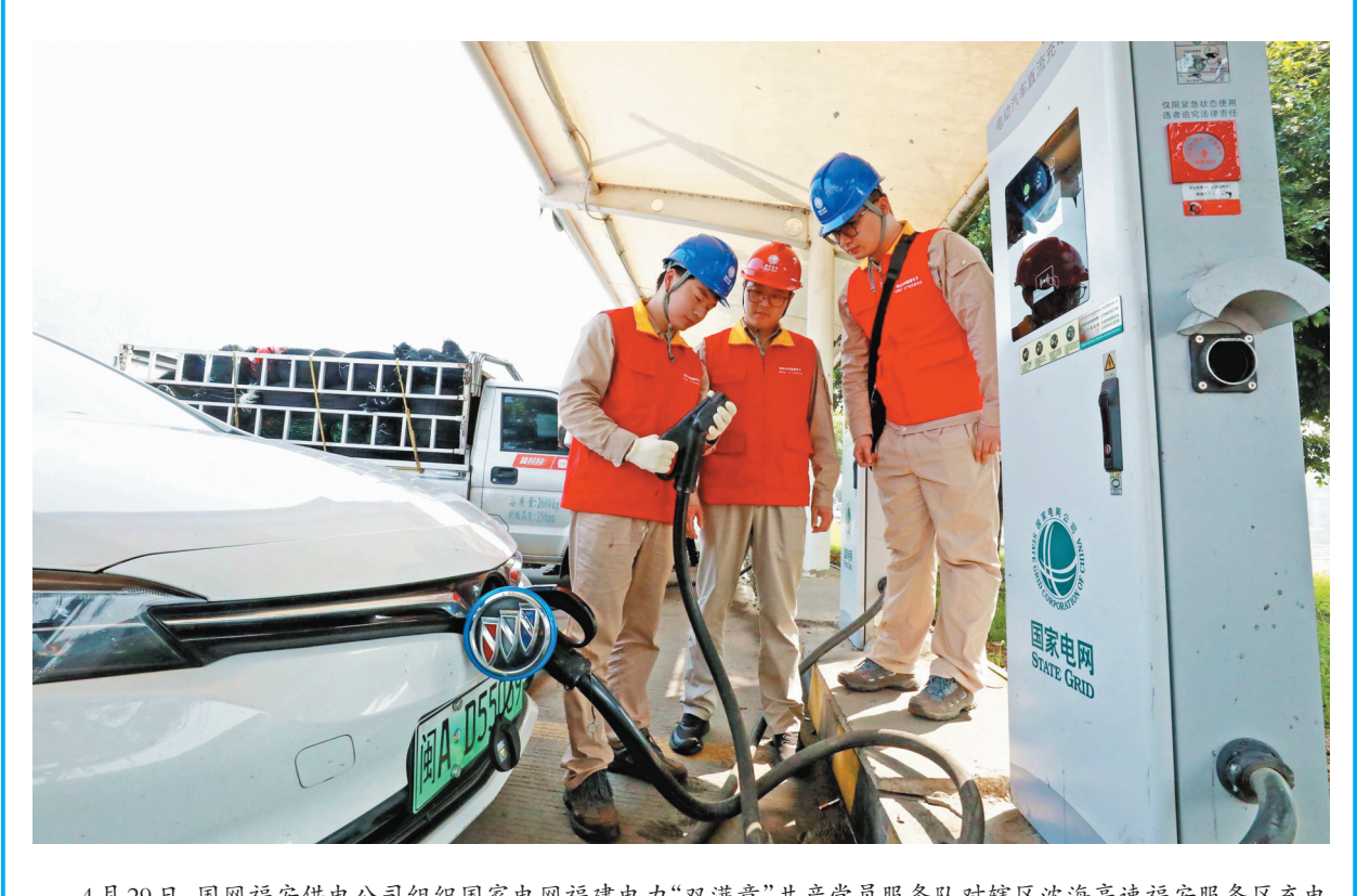
4月29日,国网福安供电公司组织国家电网福建电力“双满意”共产党员服务队对辖区沈海高速福安服务区充电站开展节前特检,及时消除充电桩设备运行隐患,保障“五一”假期新能源汽车出行充电稳定,助力广大市民、游客绿色出行无忧。 吴其文 梁荣 摄
