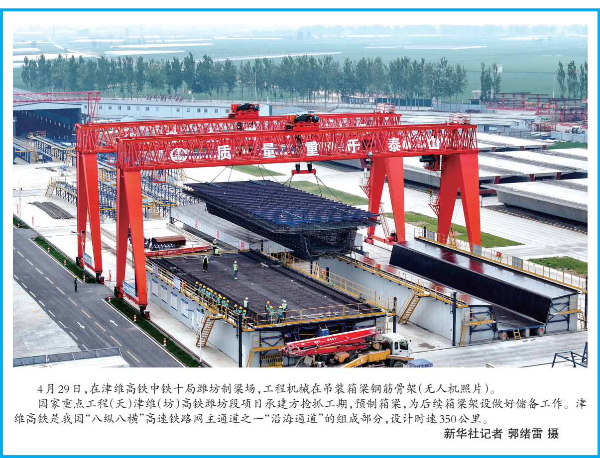
4月29日,在津维高铁中铁十局津潍制梁场,工程机械在吊装箱梁钢筋骨架(无人机照片)。国家重点工程(天)津维(坊)高铁津潍段项目承建方抢抓工期,预制箱梁,为后续箱梁架设做好储备工作。津维高铁是我国“八纵八横”高速铁路网主通道之一“沿海通道”的组成部分,设计时速350公里。 新华社记者 郭绪雷 摄
