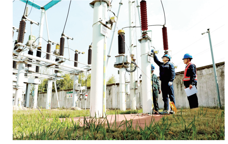
3月20日,国网福安市供电公司组织变电检修人员,对福安赛岐110千伏住宅变电站110千伏、35千伏、10千伏避雷器进行带电检测,同时对站内一、二次设备进行全面巡视检查,以此确保变电站稳定运行,为春耕备耕生产提供电力保障。 吴其文 梁荣 摄
