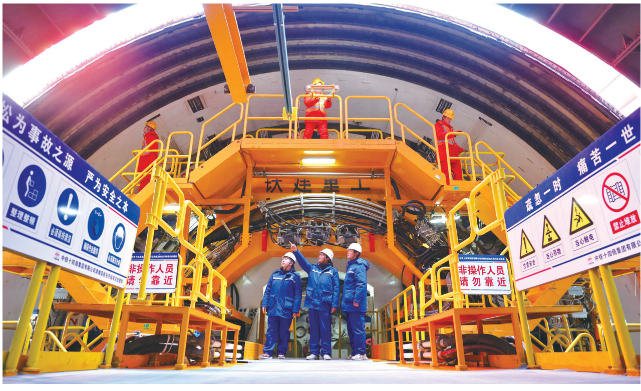
1月18日,工人在隧道内作业。当日,由中铁十四局承建的津潍高铁津海河隧道超大直径盾构机“津城一号”顺利始发,标志着京津冀地区开挖直径最大、掘进距离最长的高铁盾构隧道正式开始掘进。津潍高铁起自天津枢纽滨海站,终至济青高铁潍坊北站,正线长度348.9公里,设计时速350公里。新华社记者 邢广利 摄
