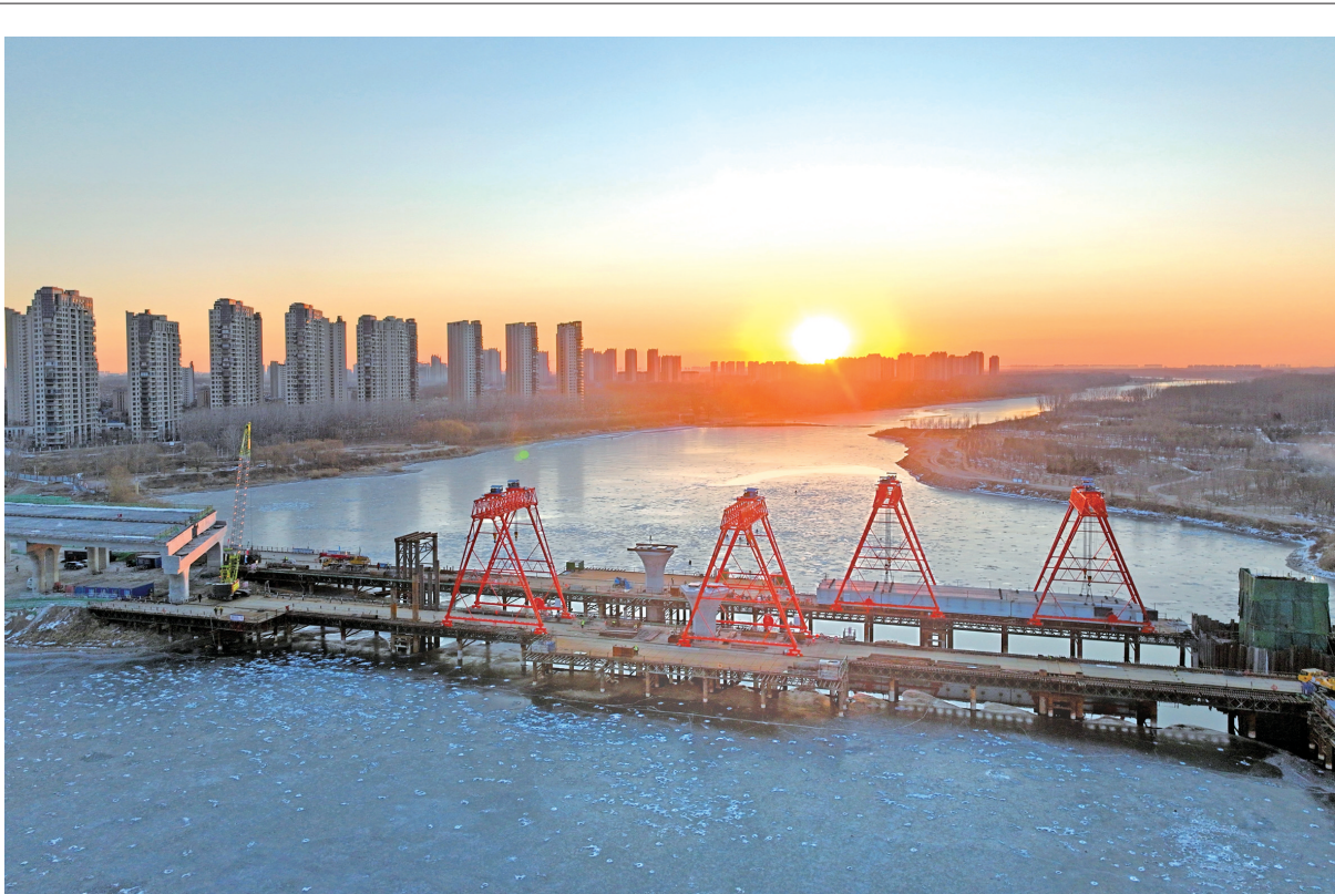
1月15日拍摄的建设中的厂通路潮白河大桥(无人机照片)。当日,厂通路(河北省大厂回族自治县至北京市通州区)潮白河大桥主桥吊装首段钢箱梁,潮白河大桥主桥即将进入上部结构施工阶段。
