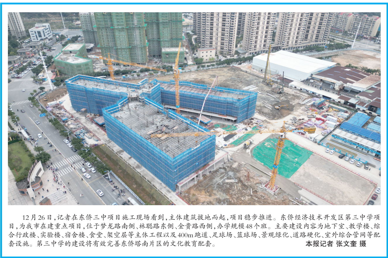
12月26日,记者在东侨三中项目施工现场看到,主体建筑拔地而起,项目稳步推进。东侨经济技术开发区第三中学项目,为我市在建重点项目,位于梦龙路南侧、林聪路东侧、金贵路西侧,办学规模48个班。主要建设内容为地下室、教学楼、综合行政楼、实验楼、宿舍楼、食堂、架空层等主体工程以及400m跑道、足球场、篮球场、景观绿化、道路硬化、室外综合管网等配套设施。第三中学的建设将有效完善东侨塔南片区的文化教育配套。 本报记者 张文奎 摄
