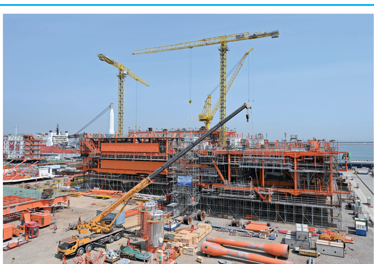
5月10日拍摄的渤中19-6凝析气田一期开发项目平台建造现场。近日,渤海油田渤中19-6凝析气田一期开发项目 WHPM(井口平台)平台主体结构在海油工程天津智能化制造基地完成封顶,标志着渤中19-6凝析气田一期开发项目4座平台主体结构全部建造完成。据了解,渤中19-6凝析气田位于渤海中部海域,是中国东部第一个大型、整装、高产、特高含凝析油的千亿方凝析气田,也是渤海湾首个千亿方大气田。 □新华社记者 赵子硕 摄
