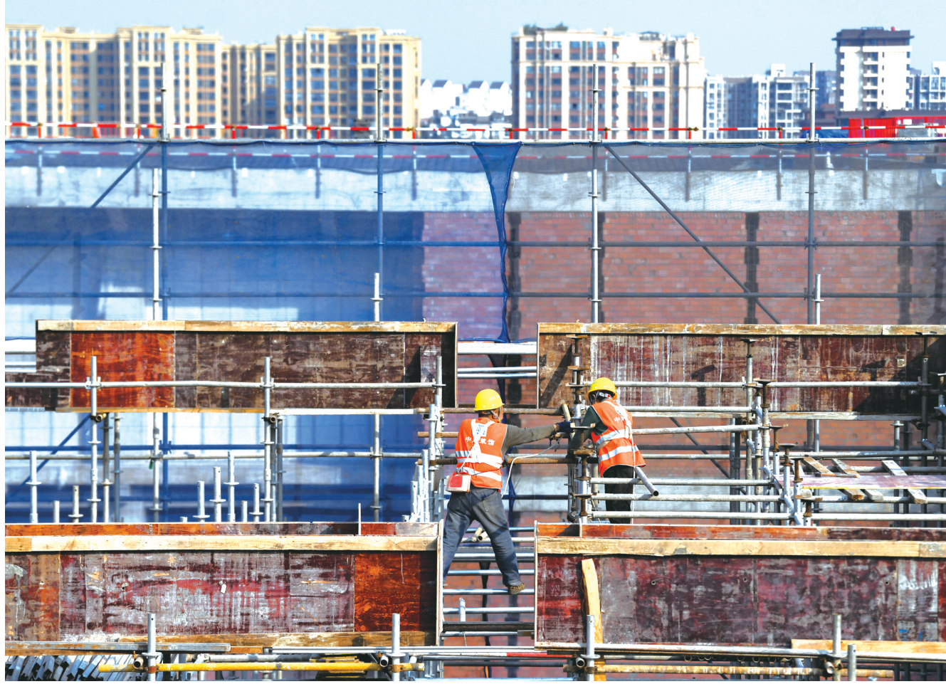
2月2日,工人在成都芯谷产业功能区配套设施建设工程施工现场作业。
